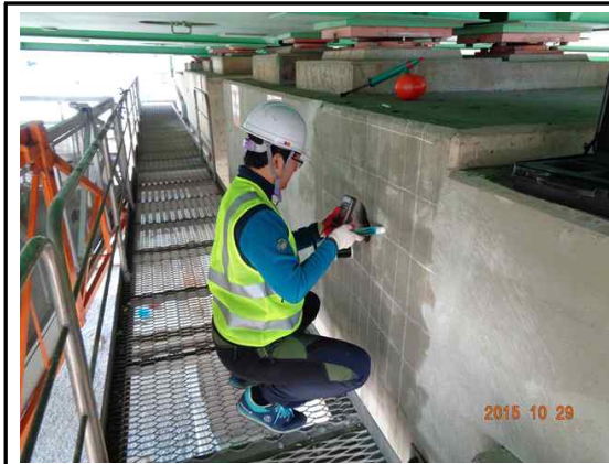
위 치 교각 내 용 철근부식도 시험
